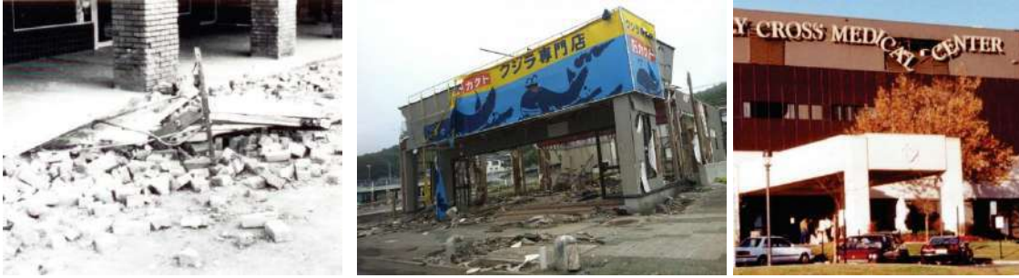
Şekil 5. (a) Dış cephedeki tanıtım ve reklam bileşenleri hasar örnekleri [FEMA E-74, 2012]
