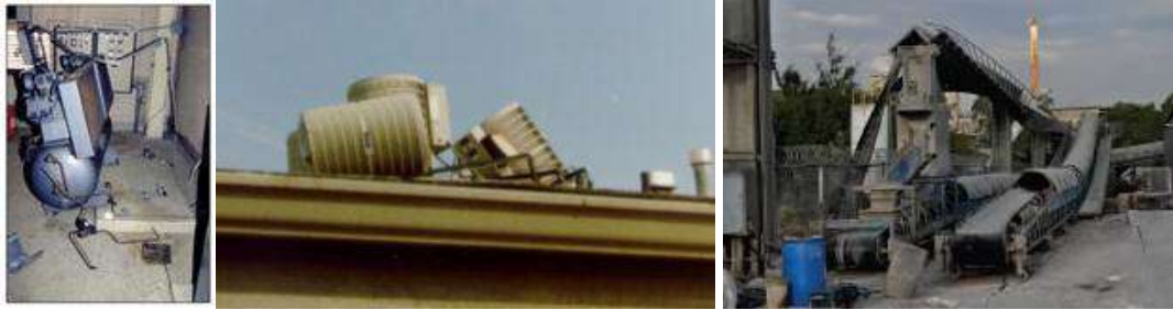
Şekil 8. Kompresör, havalandırma ünitesi ve konveyör bantta meydana gelen hasar örnekleri
