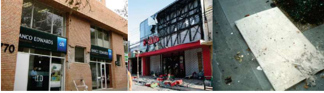
Şekil 4. Dış cephe kaplamaları hasar örnekleri [FEMA E-74, 2012]
